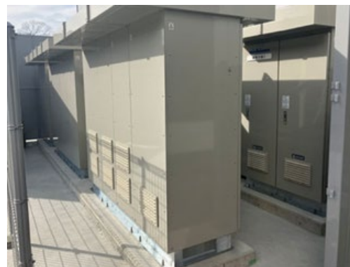
選手寮横に設置された大容量蓄電システム ・電源盤：計100kW(50kWx2セット) ・電池盤：計194.4kWh(97.2kWhx2セット)
