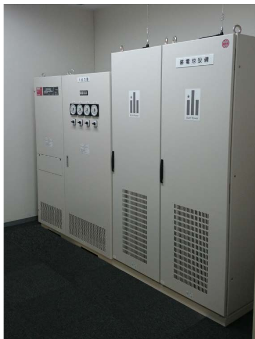
無停電電源装置 (UPS)
